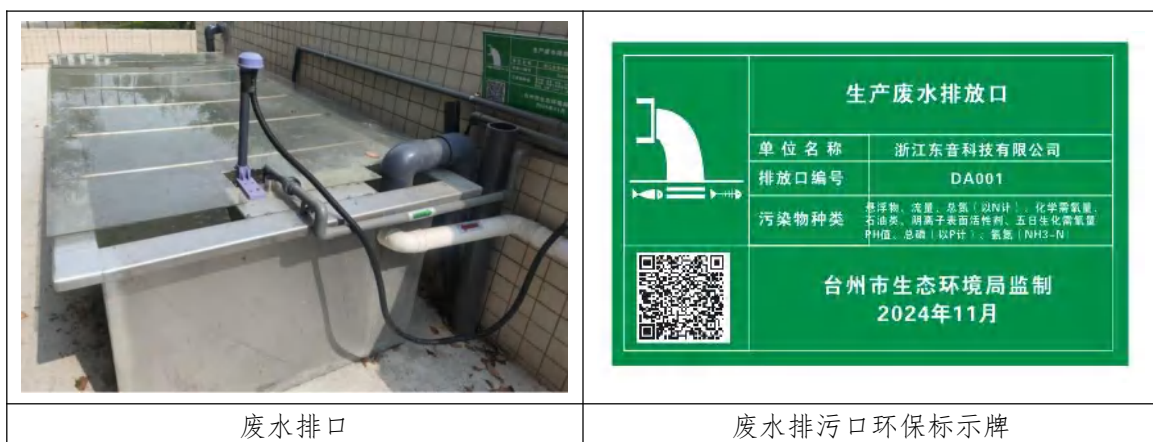
图 4.2.2-2 废水排放口现场照片
