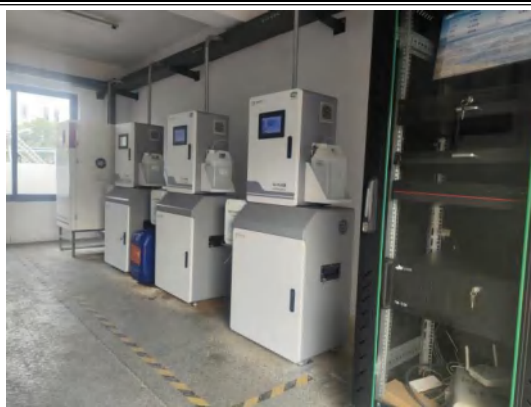
废水在线监控
