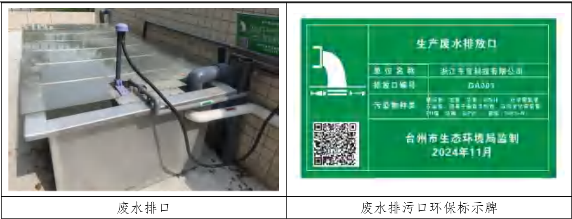
图 4.2.2-2 废水排放口现场照片
